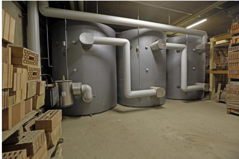
Foto: Wassertanks für die Speicherung von Fernwärme
