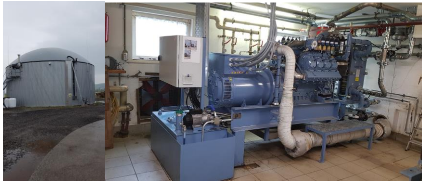
Fotos: Gasspeicher und Blockheizkraftwerk
